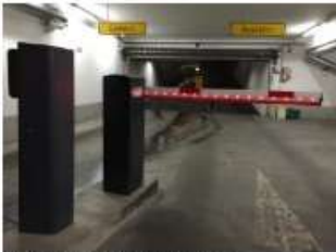
LED Parksystem Tiefgarage
