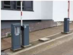
Schrankenanlage am Hang
